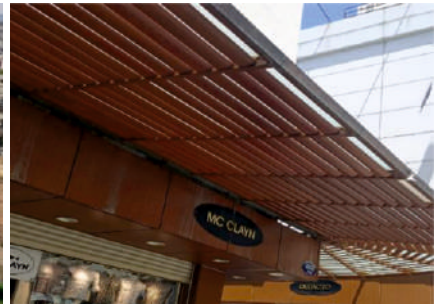
Yoğun Kar Yağıışı Sonrası Alaybey Mahallesi Çarşı Bölgesi Çöken Sundurmalar ve Hasar Gören Yerlerin Onarımı Yapım İşİ
